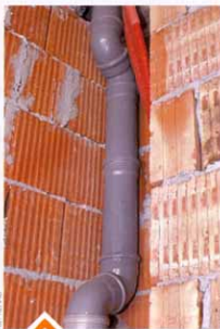
2 Odsadzka na pionie. To błąd, bo będzie źródłem hałasu. Dodatkowo jeśli rura dotyka ścian (jak na zdjęciu), hałas ten będzie się przenosił na konstrukcję budynku
