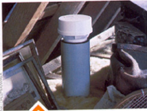
■ Zawór napowietrzający zamontowany na pionie kanalizacyjnym – na strychu
