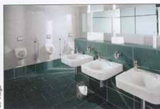
Toaleta z pisuarami sterowanymi elektronicznie, z modulem umieszczonym w ścianie
