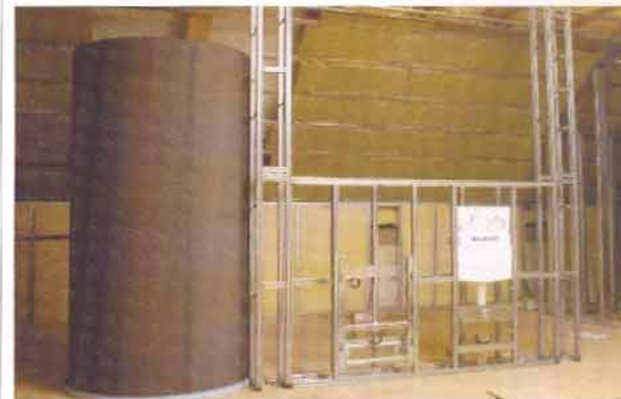
Fot. 3. Stelaż GIS zamontowany w Domu Pasywnym
